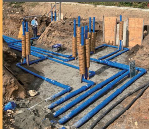
地中配管の様子
